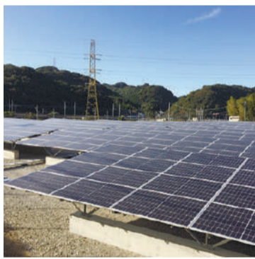
蒲田第2メガソーラー発電所
